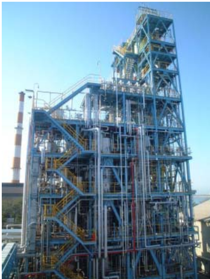
【加圧二段ガス化システム（EUP）全景】
