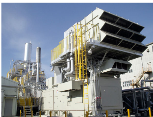
新城工場に導入したコージェネレーションシステム
