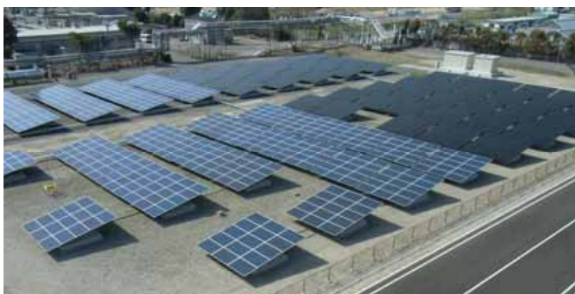
完成した茂原太陽光発電所
