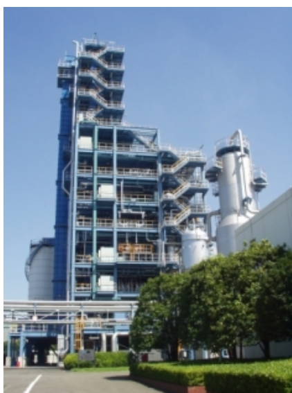
使用済みプラスチックのガス化設備
