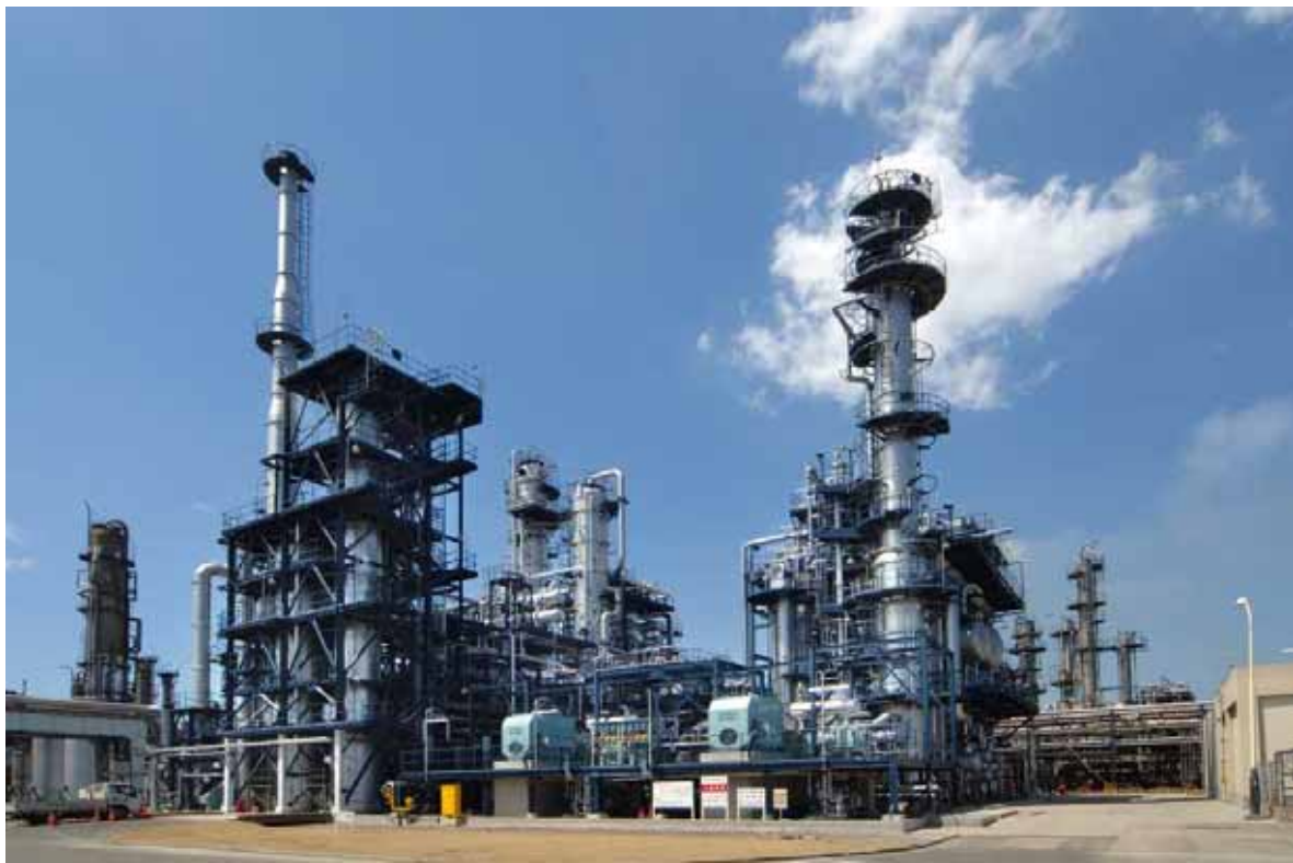
今回竣工した「サルファーフリーガソリン生産設備」 (名称：第1ガソリン脱硫装置)
