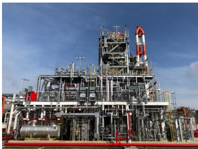
環境に配慮したエタノール由来のエチレン試験製造設備
