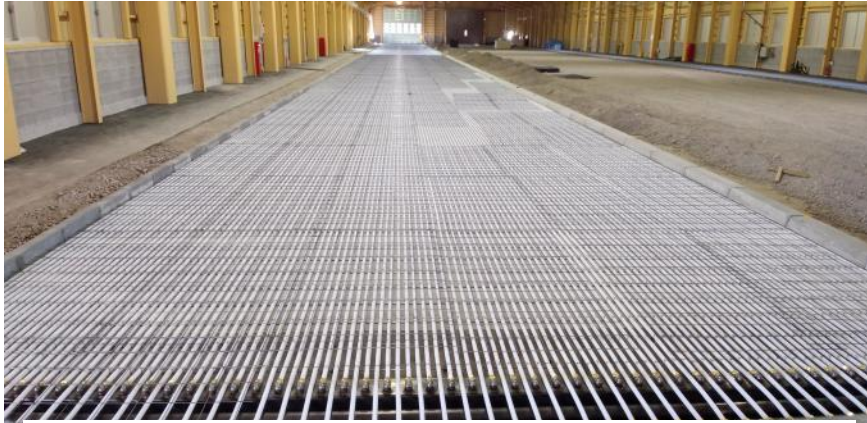
高温域から低温域までコントロール可能な冷媒装置
