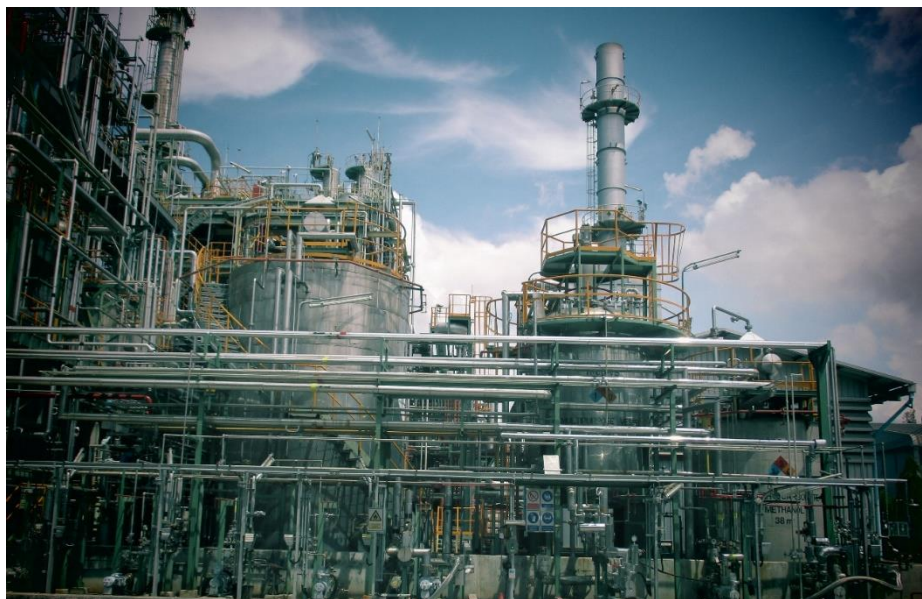
タイで稼働中のPCD製造設備（Ⅰ期・Ⅱ期）
