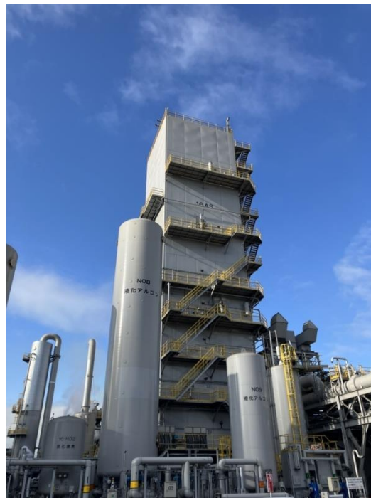
完成した空気分離装置
