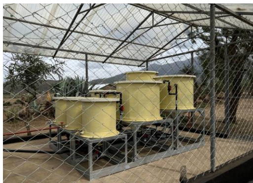
緩速ろ過型浄水プラント
