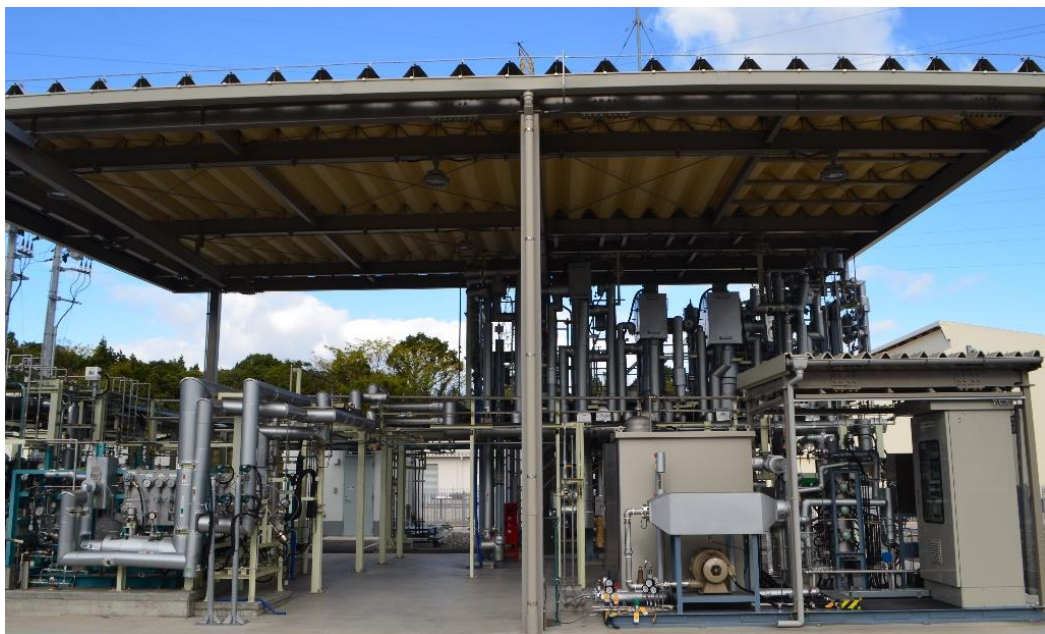
図1 カーボンリサイクル実証研究拠点内ベンチ試験設備外観
